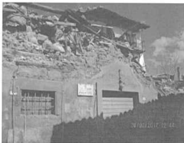
Vista esterna del fabbricato Via Roma n. 20 dopo il sisma
