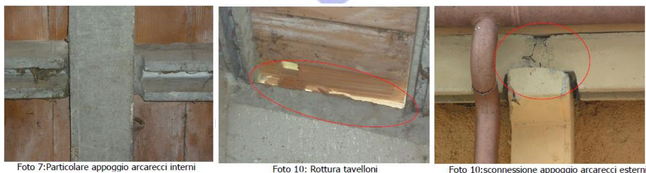
Figura 4 – Documentazione fotografica dei danni alla struttura
