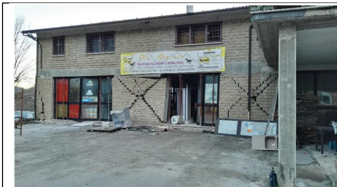
Parete con lesioni gravi e diffuse, si notano gli spancamenti dei cantonali
