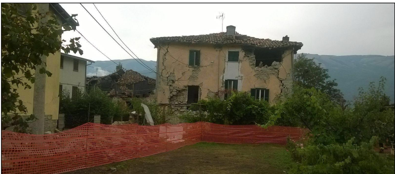
Vista esterna edificio danneggiato precedente al crollo totale
