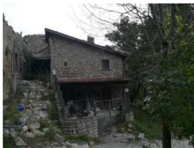
Vista esterna edificio danneggiato
