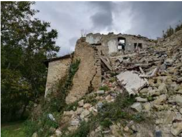
Vista esterna edificio danneggiato
