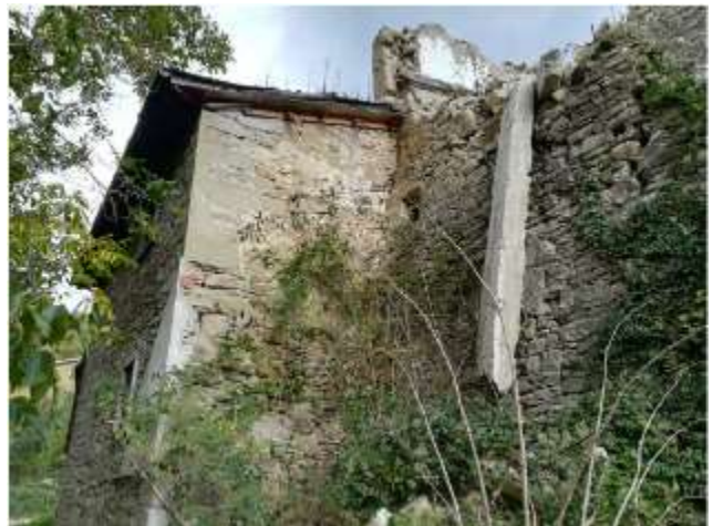
Vista esterna edificio danneggiato
