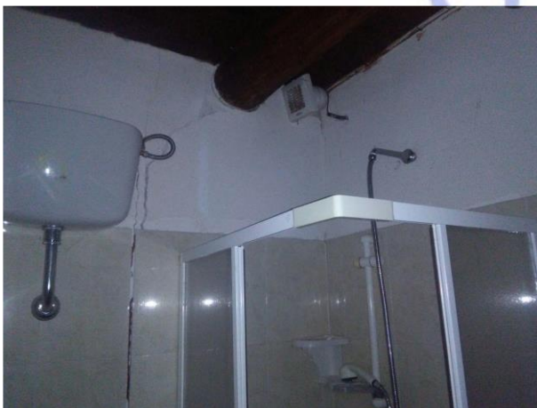
Vista interna edificio danneggiato
