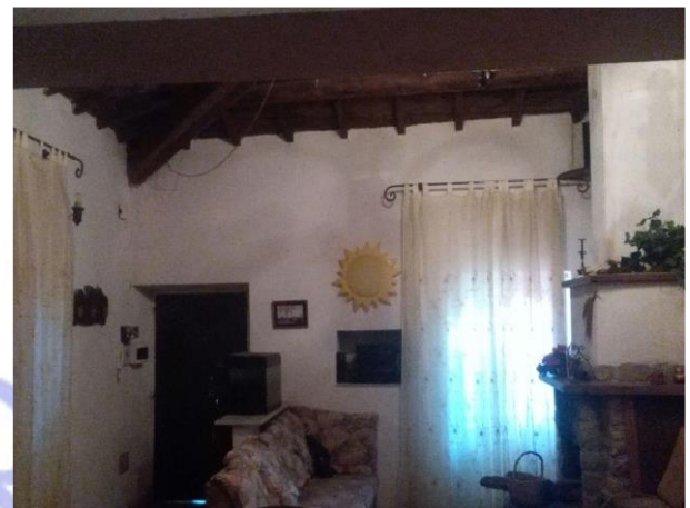
Vista interna edificio danneggiato
