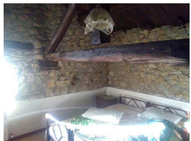
Vista interna edificio danneggiato
