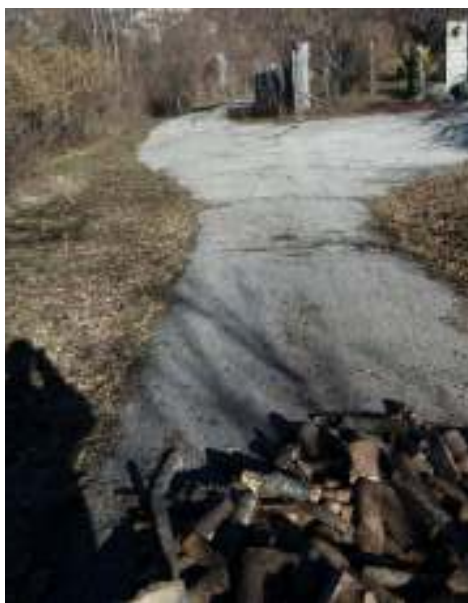
Foto 6 cedimenti del manto stradale
