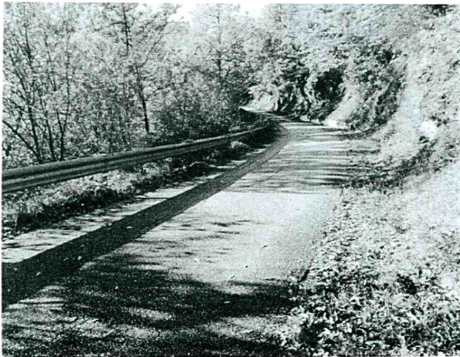
FRANA 2 CON SEDE STRADALE DISCONNESSA VERSO VALLE
