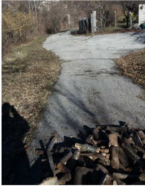
Foto 6 cedimenti del manto stradale
