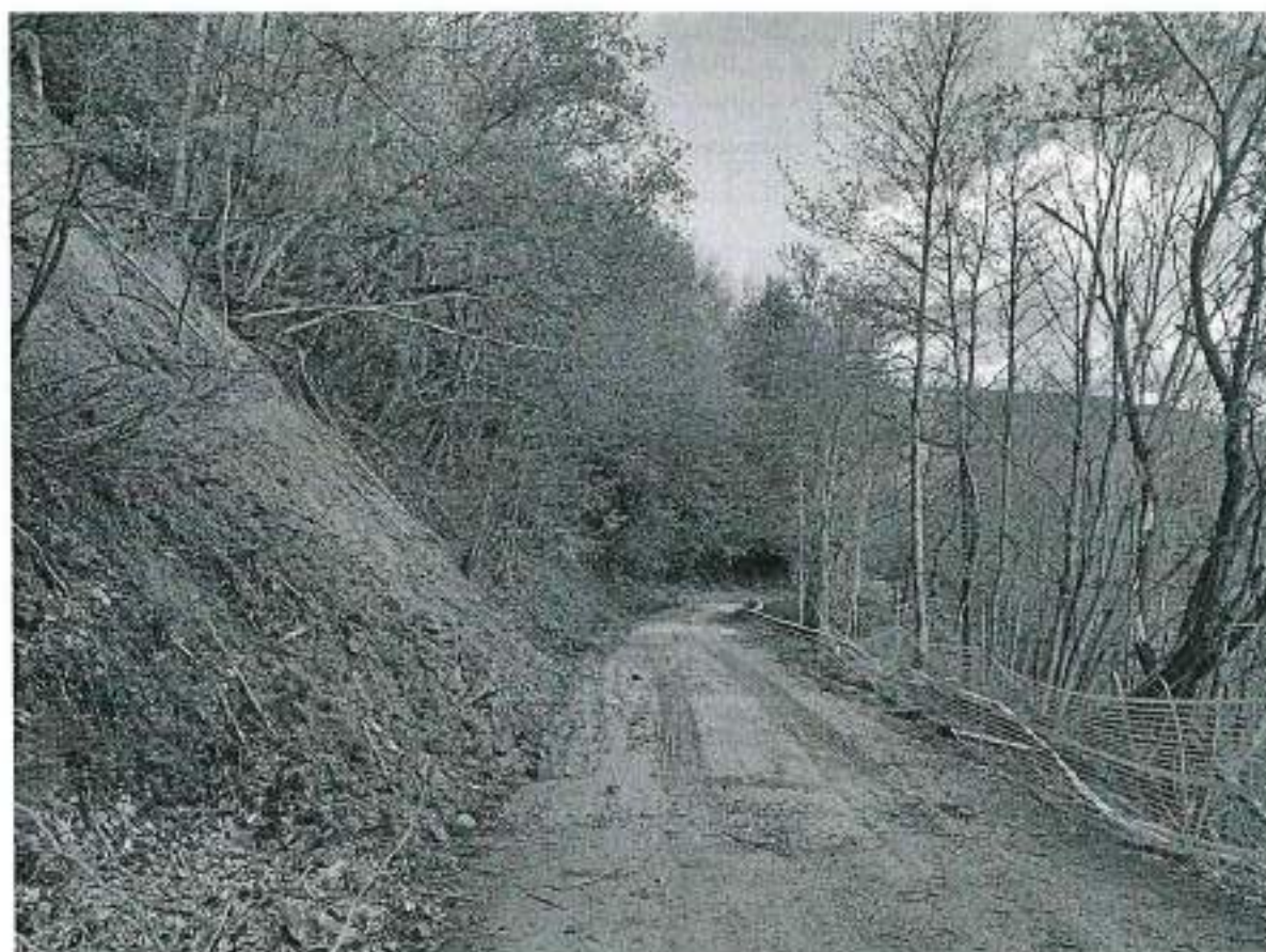
Foto 6: Dissesti lungo la viabilità comunale di accesso all'abitato
