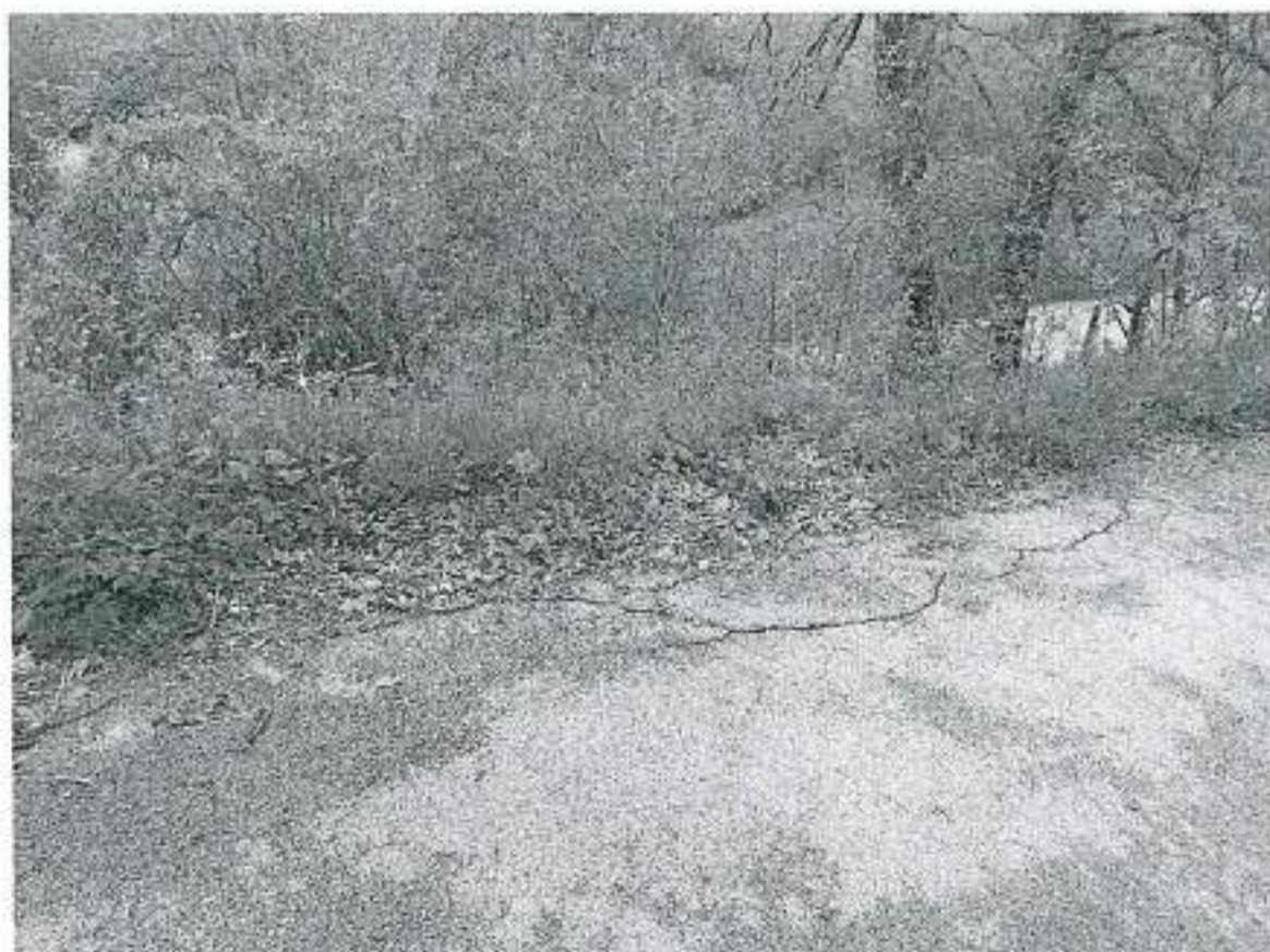
Foto 1: Cedimenti interni all'abitato
