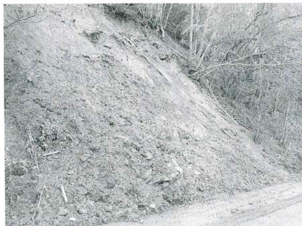
Foto 8: Dissesti lungo la viabilità comunale di accesso all'abitato
