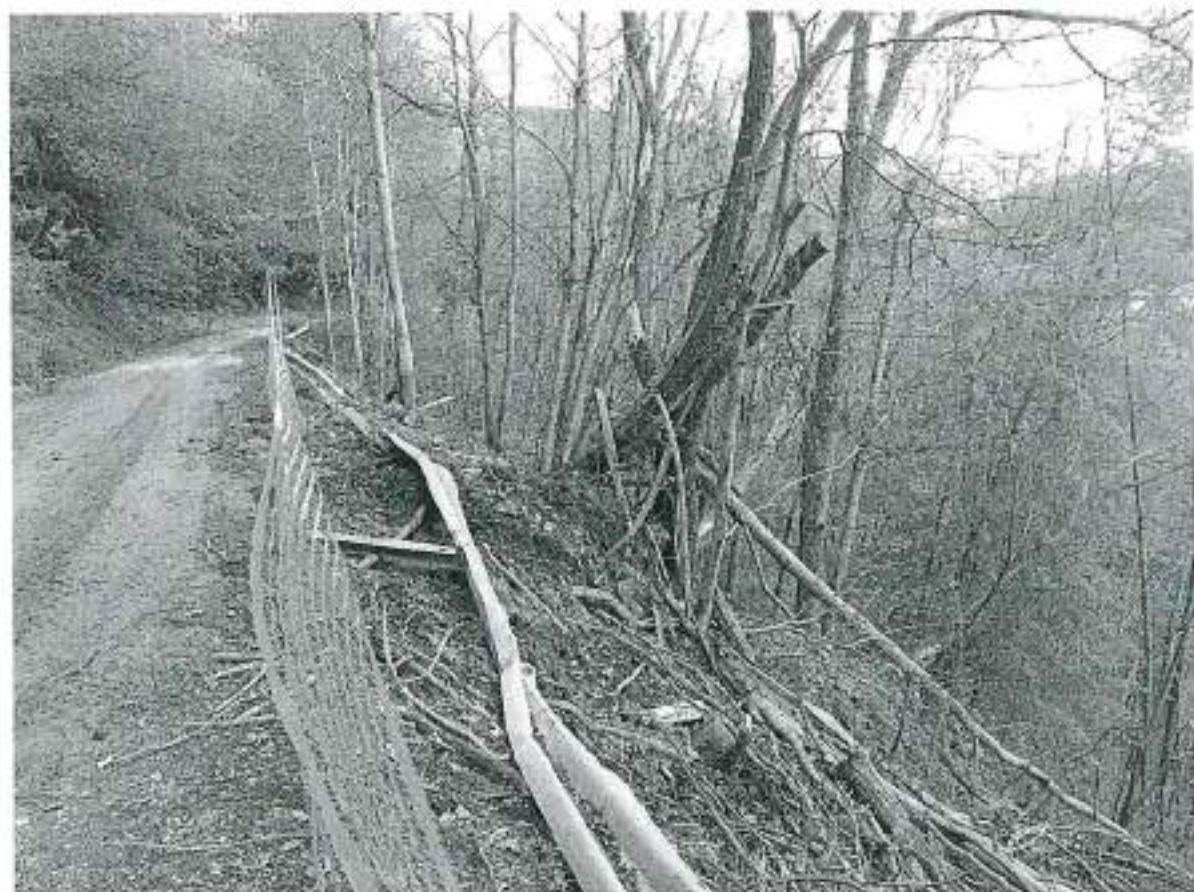
Foto 7: Dissesti lungo la viabilità comunale di accesso all'abitato
