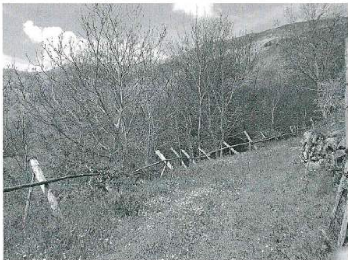
Foto 5: Cedimenti interni all'abitato
