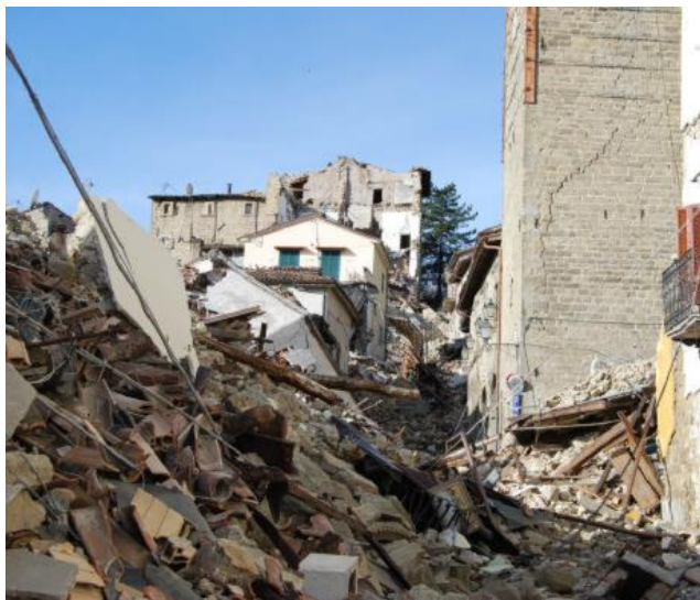
Vista esterna edificio danneggiato
