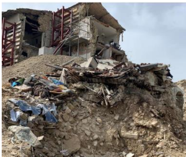
Vista esterna edificio danneggiato
